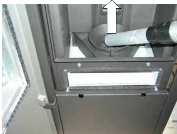
Fig. 168 : nettoyage du pot brûleur
