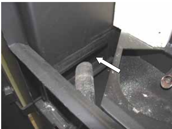
Fig. 47 : nettoyage de tirage de gaz de combustion inférieur
