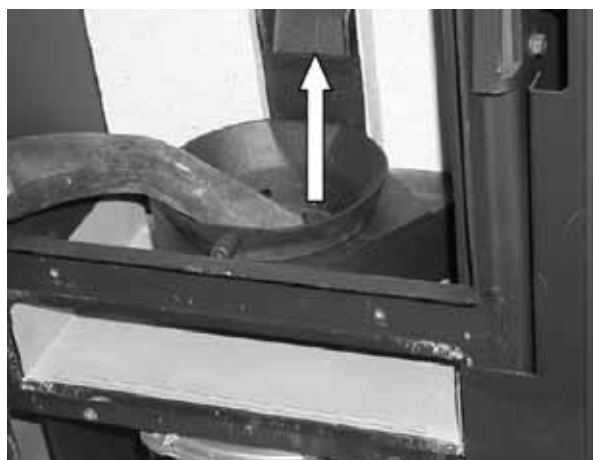
Fig. 59 : nettoyage du pot brûleur
